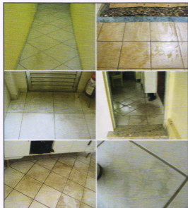
Figura 01: Fotos de produtos atacados quimicamente durante o uso. O ataque químico geralmente ocorre em decorrência de manutenção inadequada do produto.
